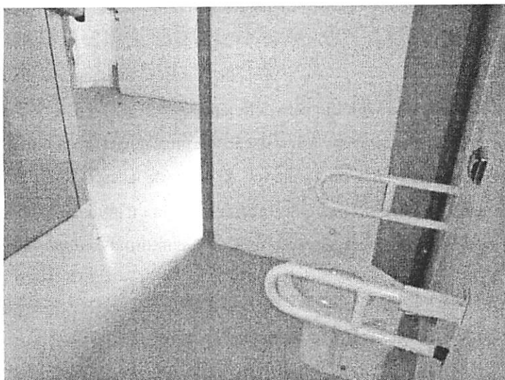
FIGURA 119 Sanitário de deficiente físico
