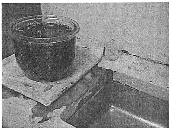
FIGURA 53 Corrosão da bancada de concreto pintada com tinta epóxi
