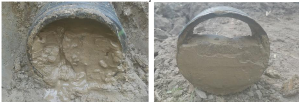
Figura 1.6 - Drenos subterrâneos obstruídos devido ao carreamento de partículas sólidas que se acumularam no interior das tubulações.
