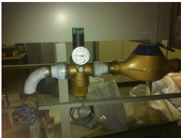
Figura 6 - Registro tipo gaveta, válvula reguladora de pressão e hidrômetro para o controle do fluxo de água.
